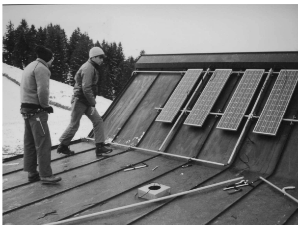
Die Elektrizität hält Einzug. Solarzellen auf dem Dach.
